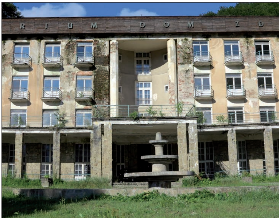
Fot. 5. Żegiestów. Modernistyczny Dom Zdrojowy, cenny zabytek w stanie zagrożenia i destrukcji. Niewykorzystana szansa mariażu turystyki i historii? (fot. A. Siwek 2015)
